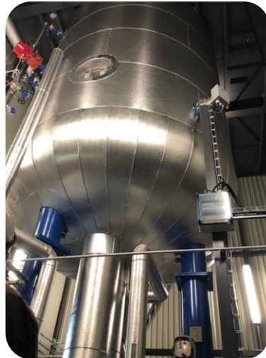
Záložní zdroj tepla – elektrokotelna v Elektrárně Poříčív
