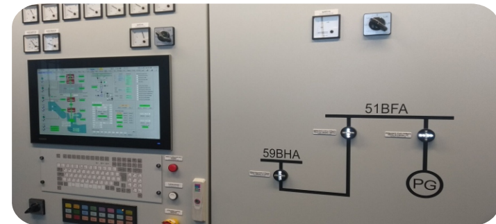
Rekonstrukce systému řízení kontrol, el. ochran, buzení generátorů, Elektrárna Slapy
