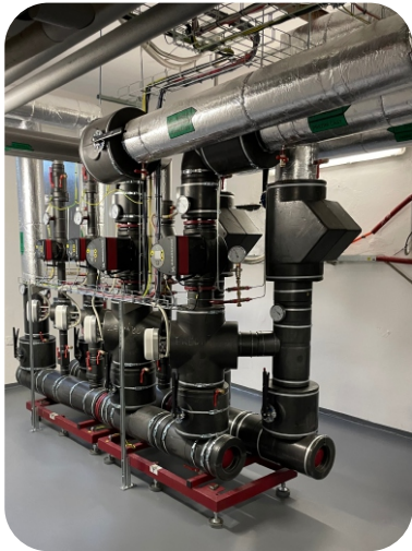
Výměníková stanice pára-voda v areálu EUC Polikliniky
