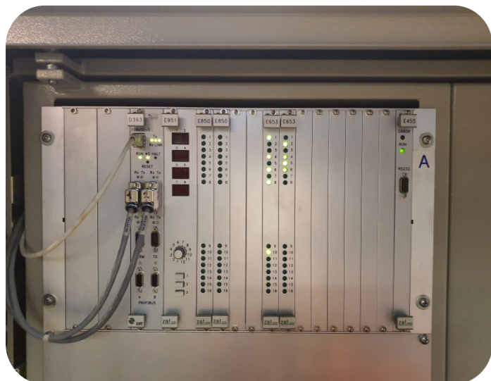
Záměna řídicího systému dekontaminačních van v Jaderné elektrárně Temelín
