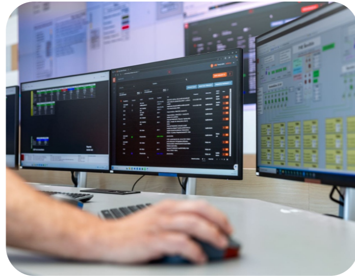
Dispečerské centrum pro řízení obnovitelných zdrojů v Málkově
