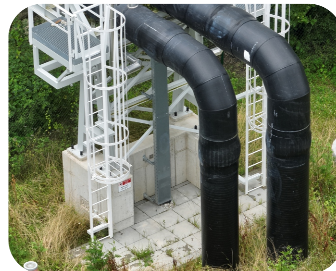
Teplný napáječ Elektrárna Temelín - České Budějovice
