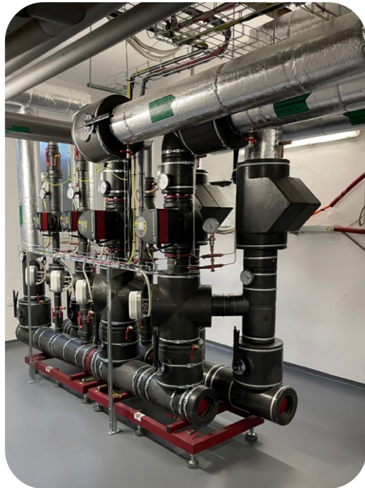
Výměňiková stanice pára-voda v areálu EUC Polikliniky
