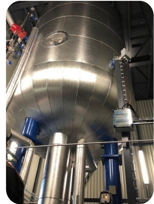
Záložní zdroj tepla – elektrokotelna v Elektrárně Poříčí
